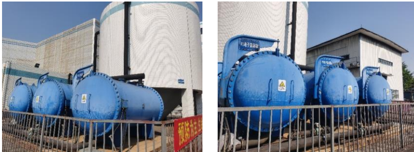
图 3.4-4 含煤废水处理系统现状照片
