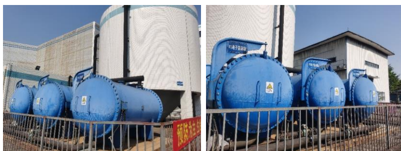
图 8.2-5 含煤废水处理系统现状照片
