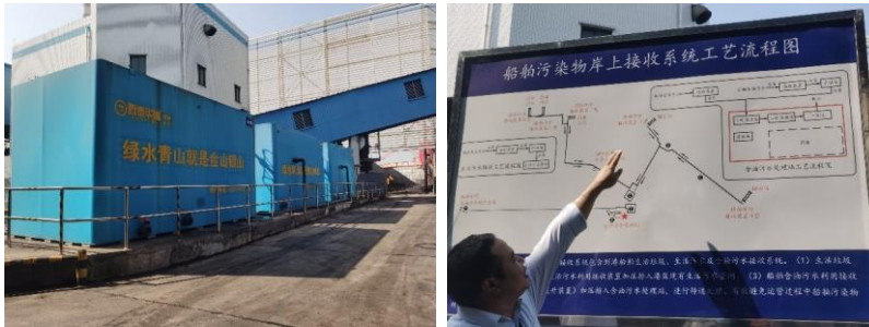
图 8.2-3 含油废水处理站现状照片
